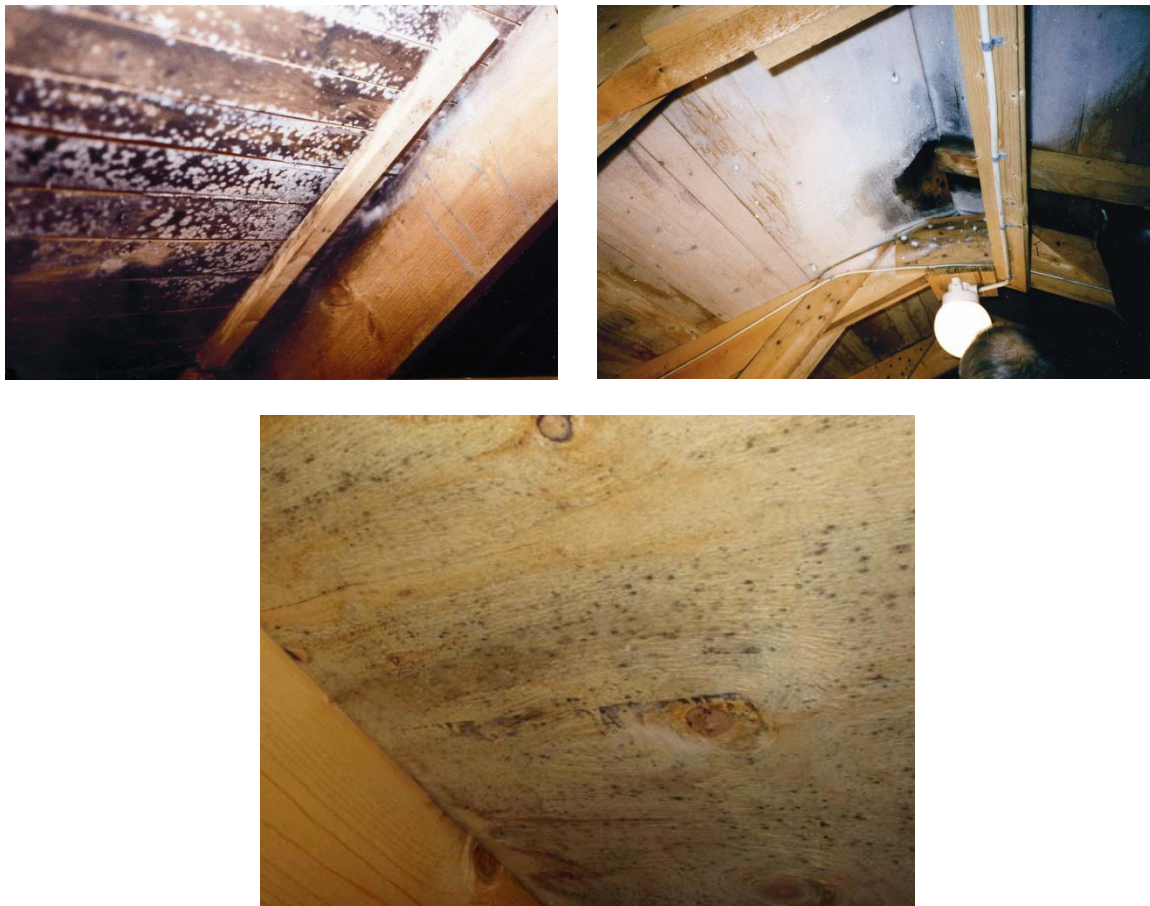
Figur 1. Exempel på olika fuktskador
